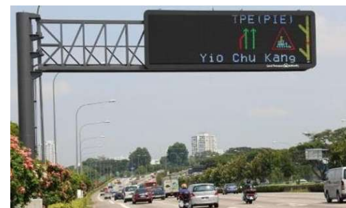
高速道路監視システム
